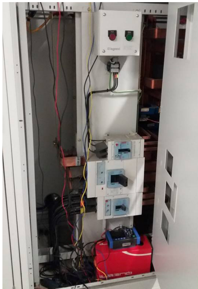
Figura 1. Analizador de potencia Hioki 3360-21 en el transformador del Área Académica
